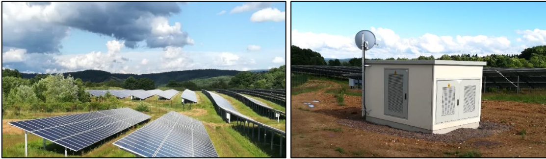
Abb. 2: Beispiel einer Freiflächenanlage (links) und einer Trafostation (rechts) (Foto: BGHplan Juni 2017).
